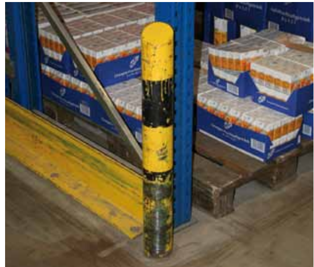
Abb. 14: Besonders stabil ausgeführter Anfahrerschutz
