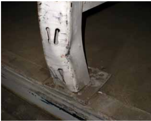
Abb. 12: Gerissene Schweißnaht an der Fußplatte der Stütze
