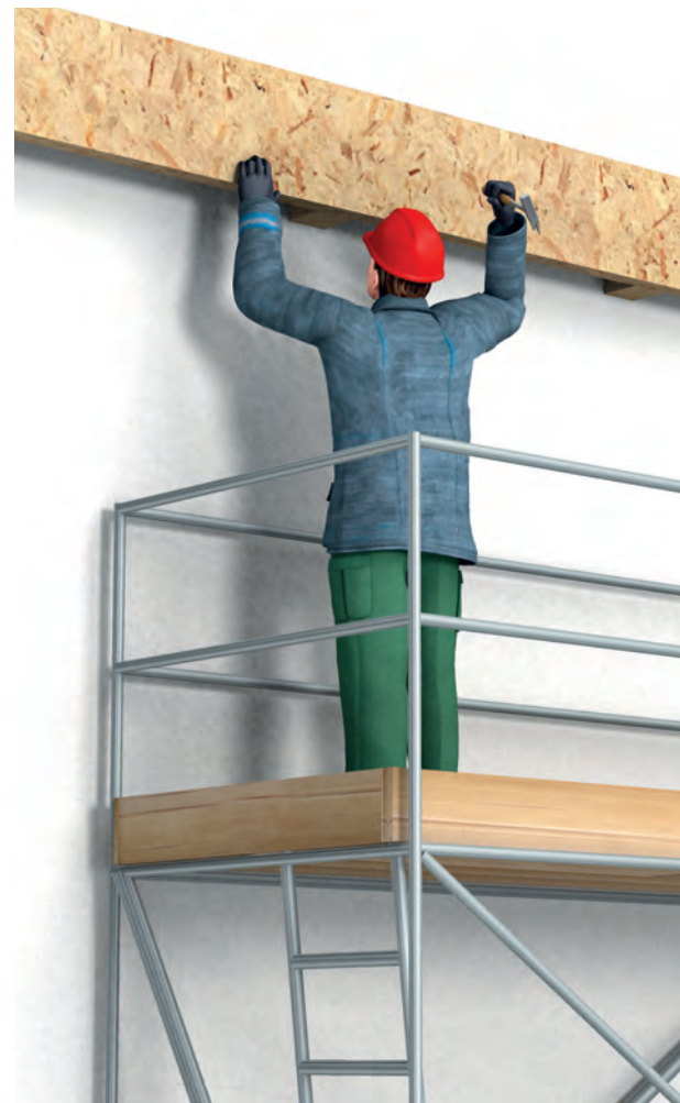
Durchstieg vor Arbeitsbeginn schließen
